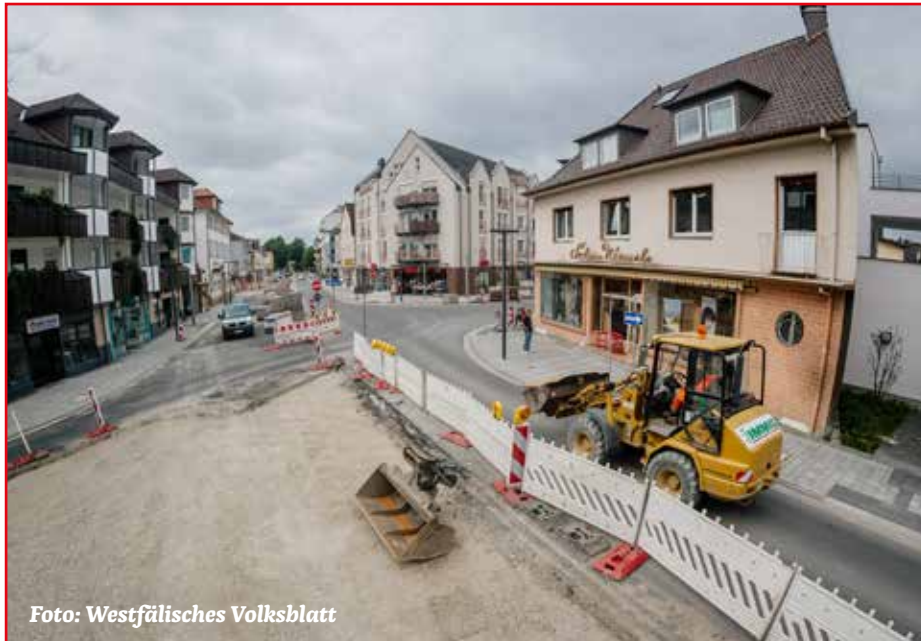
Die für 3,5 Millionen Euro umgebaute Detmolder Straße wird am 4. November für den Verkehr freigegeben.
