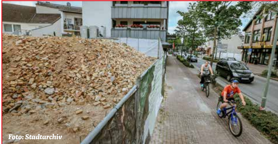
Ein Hauseigentümer an der Detmolder Straße bekommt einigen Ärger. Er hat sein Haus an der Detmolder Straße ohne Genehmigung abgerissen und womöglich auch ein Denkmal zerstört.
